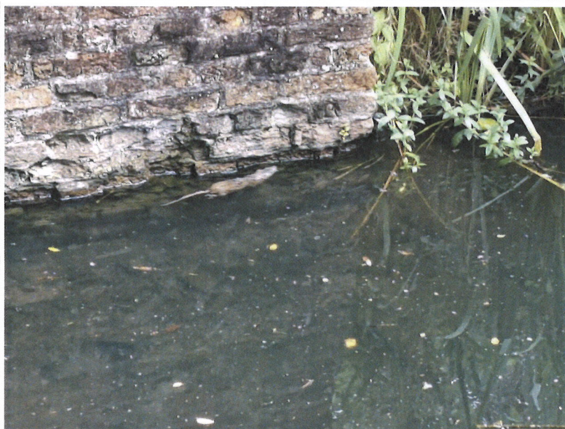
Beschrijving bij foto 11: Poortgebouw Uitgesleten voegwerk, stenen en begroeiing.
