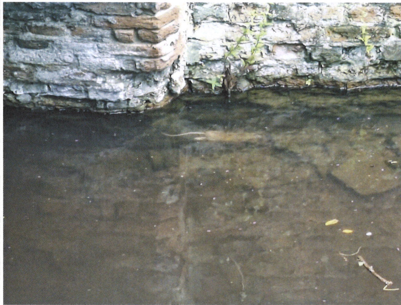
Beschrijving bij foto 10: Poortgebouw Uitgesleten voegwerk en uitgesleten stenen.
