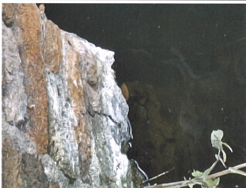
Beschrijving bij foto 12: Poortgebouw Uitgesleten stenen aanwezig en verspreid stenen weggevallen.
