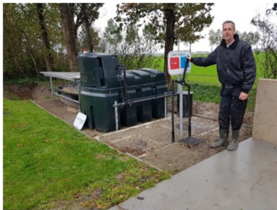
Wasplaats met zuiveringssysteem en tweewegklep
