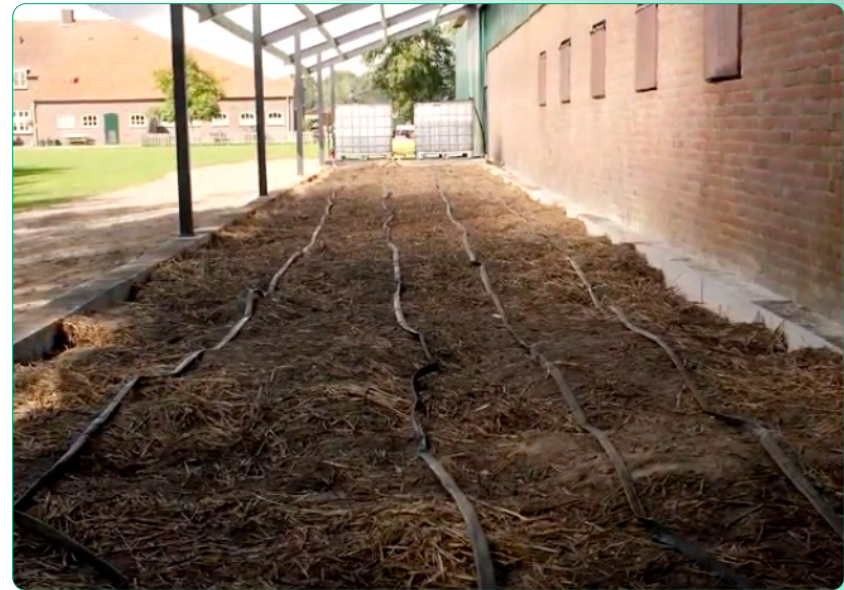
Een betonnen fytobak voor meer capaciteit.
