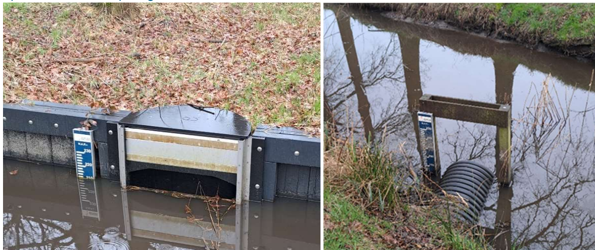
Figuur 3.1: geplaatste stuw en uitmonding op landgoed Sterkenburg (foto: RHDHV, 5 maart 2024)
